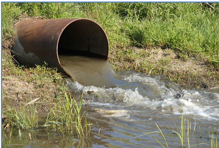
Slika 26. Nekontrolirano ispuštanje nepročišćenih otpadnih voda u okoliš 91
